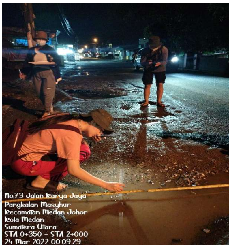
Foto kondisi jalan
