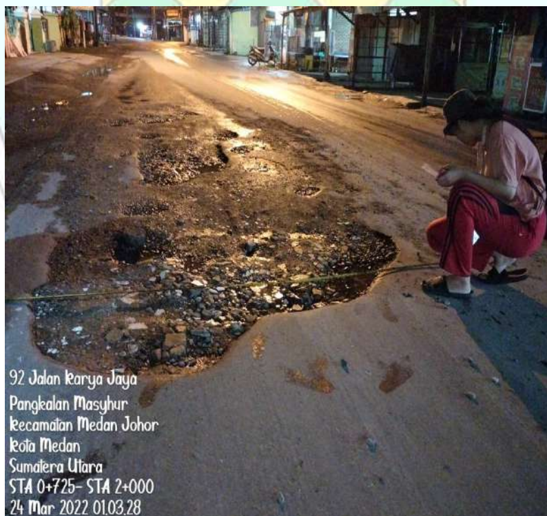
Foto pada saat mengukur dimensi kerusakan
